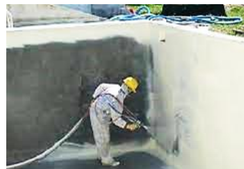
Резервоари за отпадни води
