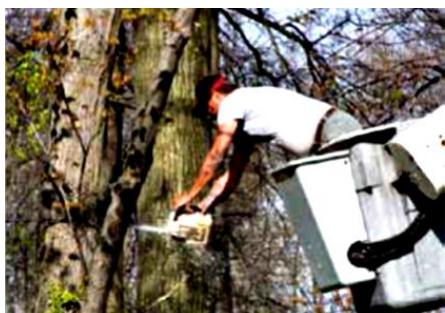
Nieprawidłowe użycie i brak ŚOI
