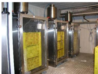
Komory chłodnicze z kontrolowaną atmosferą
